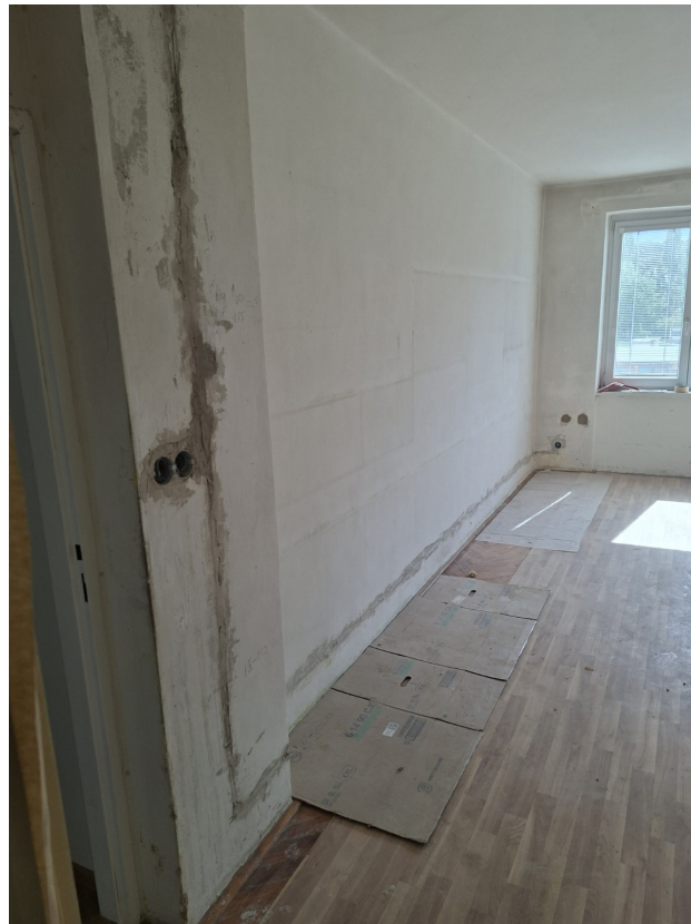
F24 | 33776.jpg — Svislá instalační trasa u dveří se dvěma neosazenými krabicemi, odlišná místa na stěně a pruhy kartonu při podlaze. Fotografie propojuje téma oprav podkladu s ochranou zůstávajícího vybavení.
