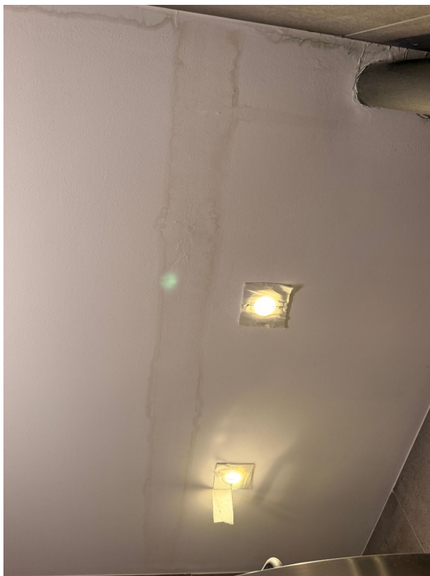
F17 | 33842.jpg — Koupelnový strop s nepravidelnými mapami, prostupem potrubí a rozsvícenými bodovými světly s částečným oblepením. Mapy mohou připomínat stopy po zavlhnutí, ale fotografie nepotvrzuje příčinu ani aktuální vlhkost.
