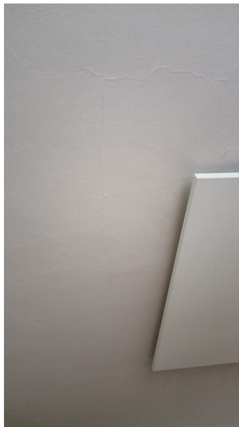
F18 | 33840.jpg — Detail světlého povrchu s nepravidelnými obrysy a místy zdviženými či odlupujícími se okraji povrchové vrstvy. Před volbou opravy je potřeba na místě rozlišit, která vrstva ztratila soudržnost.
