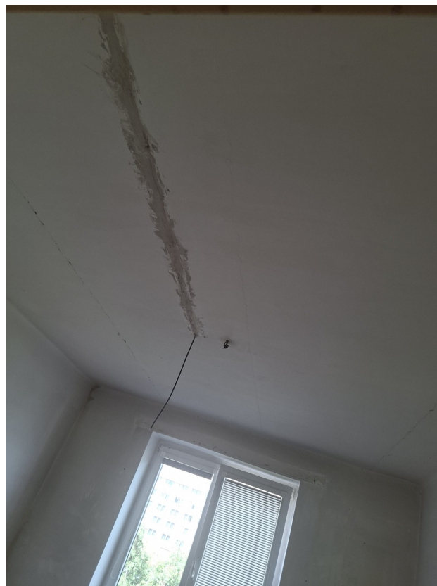
F22 | 33778.jpg — Pohled na strop s podélnou zapravenou trasou, volným kabelovým vývodem a dalšími tenkými liniemi prasklin. Je potřeba rozlišit opravu instalační drážky od řešení samostatných prasklin; jejich příčinu fotografie neurčuje.
