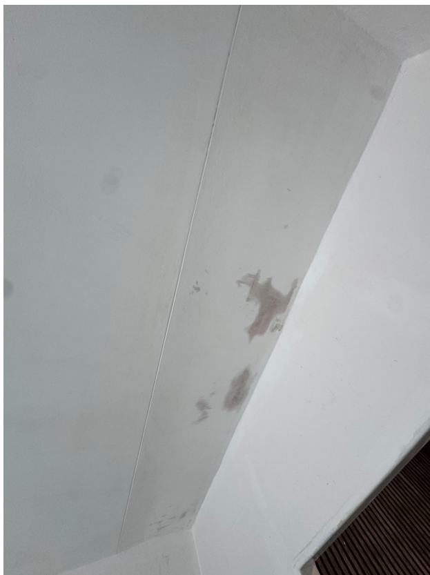
F13 | 33846.jpg — Detail horní části místnosti s přímou spárou a místy odlišným nebo chybějícím povrchem. Z fotografie nelze určit materiál jednotlivých vrstev ani to, zda jde o poškození, nebo rozpracovanou opravu.
